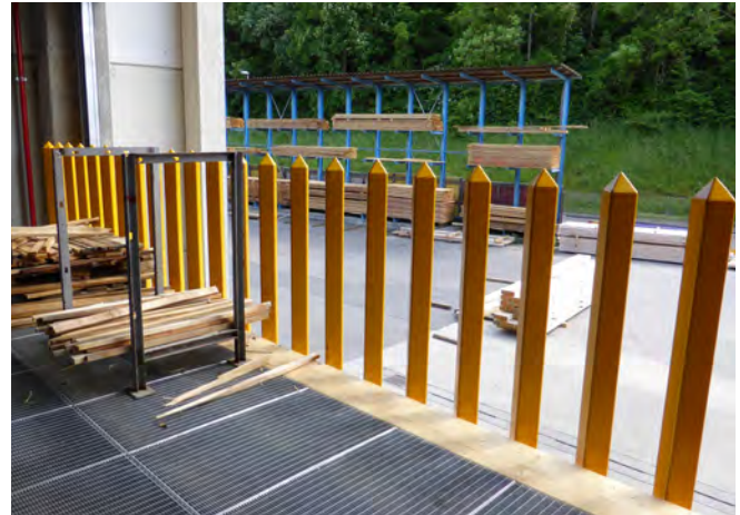
Abb. 51 Absturzsicherung durch Palisaden aus Stahl an erhöhtem Stapelplatz mit Übergabebereich
