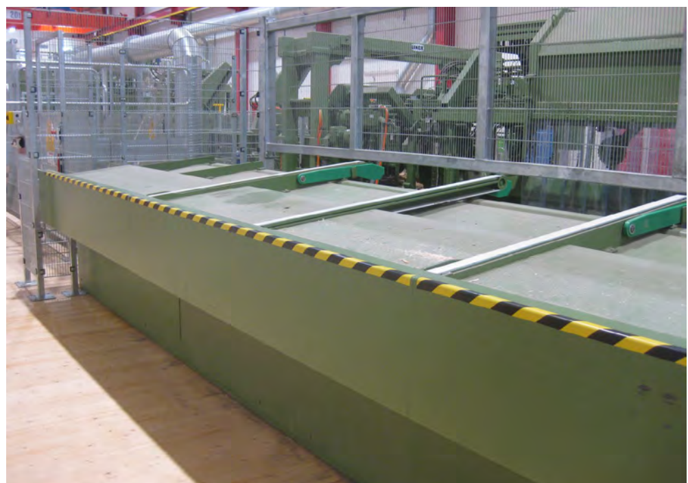
Abb. 22 Beispiel 2, Messstelle außerhalb des Gefahrbereichs
