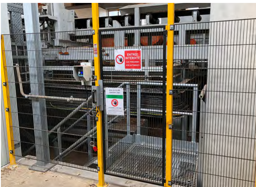
Abb. 46 Elektrisch verriegelte Zugangstür
